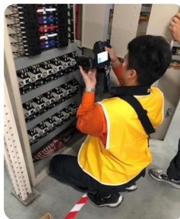
▶ 圖 5-22、企業損防顧問電氣設備安全檢測（紅外線）
